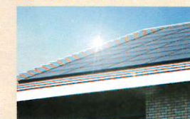
太陽光パネル
